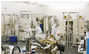
クラス 100、クラス 10000 のクリーンルーム
